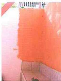
FOTOGRAFÍA No. 9 Cernido en muros
