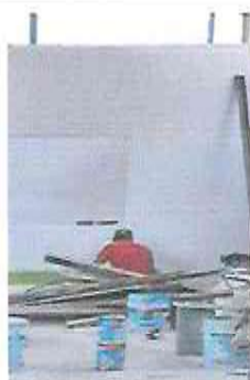
FOTOGRAFÍA No. 9 Cernido en muros
