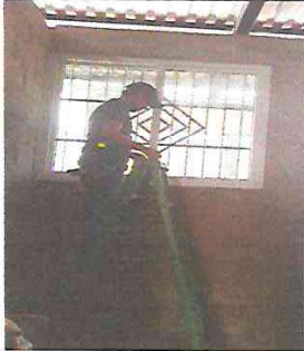
FOTOGRAFIA: SITUACION DE VENTAS DE PVC EN MODULO DE DIRECCION
