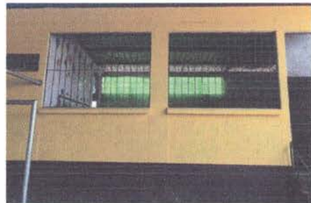
Foto 12. Pared en ventana
