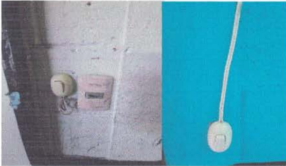
Foto 7. Sustrucción de interruptores simples
