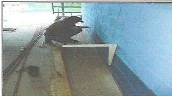
Foto 2: Suministro de mesa de concreto para alimentación escolar
