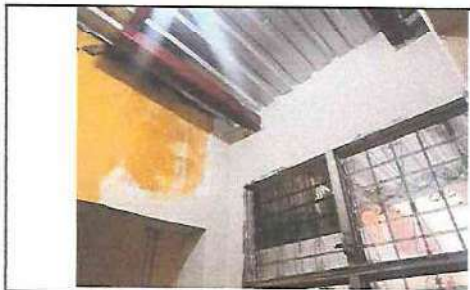
FOTOGRAFIA: REPARACION DE FILTRACION ENTRE LAMINA Y PARED MODULO COCINA
