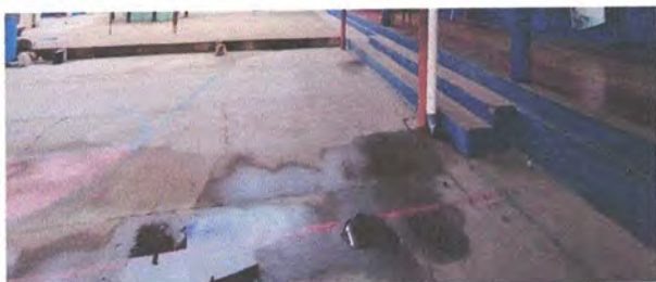
SALIDA DE TUBERIA DE AGUAS GRISES
