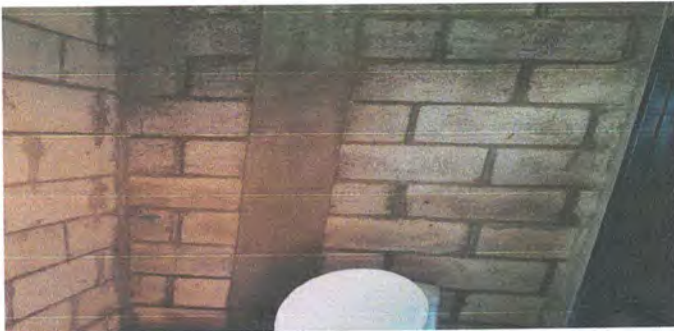
FOTO 9. REPELLO Y CEERNIDO EN MUROS DE BAÑOS
