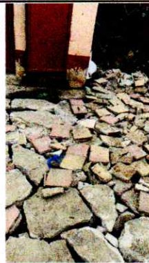
Foto 9: Módulo B, piso exterior de baños en mal estado
