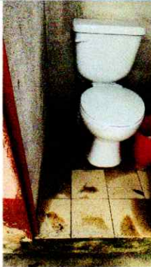
Foto 7: Módulo B, baño con fugas
