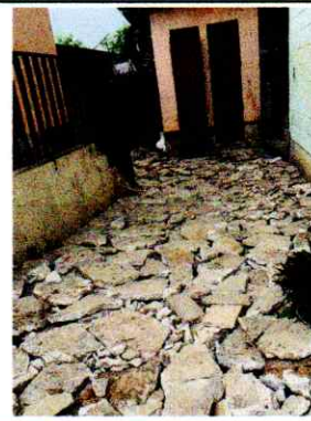
Foto 10: Módulo B, piso exterior y puertas de baño en mal estado
