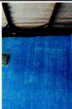
Foto 3: Módulo A, pared con filtración
