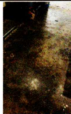
Foto 4: Módulo A, piso de aulas en mal estado
