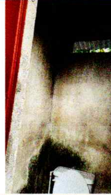
Foto 8: Módulo B, lámina y estructura metálica de baños en mal estado
