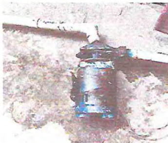
Foto 17. Sustrucción de Bomba de agua
