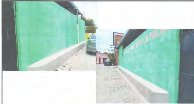
Foto1: Pintura en Muro-perimetral
