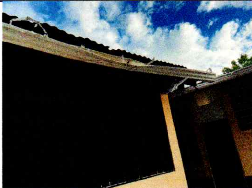
Foto 8: Módulo A, canal doblado
