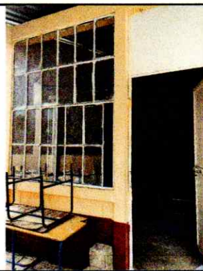
Foto 10: Módulo A, ventanas no cuentan con balcones
