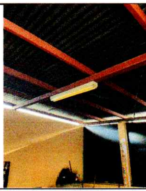
Foto 6: Módulo A, luminarias en mal estado
