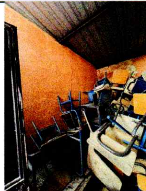
Foto 2: Lámina en mal estado
