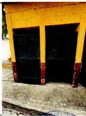
Foto 5: Módulo B, puertas de baños con pintura en mal estado
