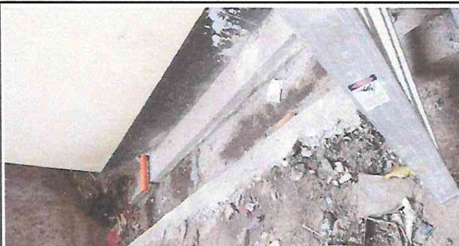
Foto 3: CUNETA TRAGANTE PARA AGUA DE LLUVIA
