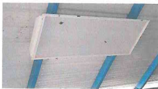
Foto1: MANTENIMIENTO SISTEMA ELECTRICO
