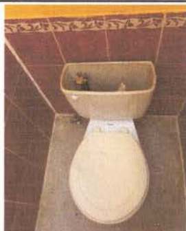
Foto 5: Sustrucción de accesorios de inodoros
