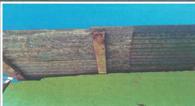
Foto 1: AULA 2 PREPRIMARIA, DAÑOS EN TECHO DE LAMINA Y MADERA.
