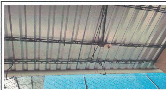
Foto 4: SISTEMA ELECTRICO MAL ESTADO, ILUMINACION.
