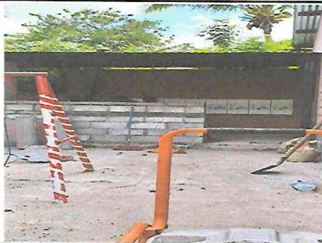
Foto 3: Muro en cocina.
