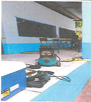
Foto 9: Pintura de balcón en aula
