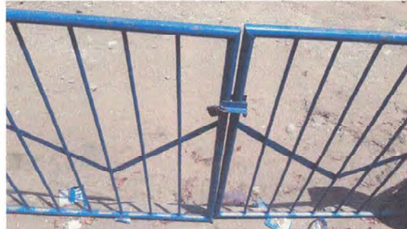
Foto 16: Mantenimiento de barandas de metal que se encuentran en mal estado.
