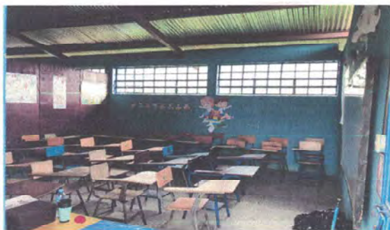
Foto 9: Pintura en muros interiores se encuentra en mal estado.
