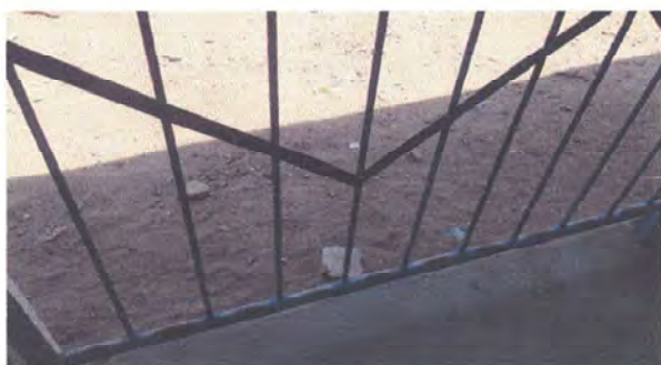
Foto 15: Mantenimiento de barandas de metal que están deterioradas.
