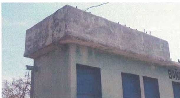
Foto 13: Pintura en muros exteriores que se encuentran en mal estado.
