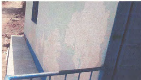
Foto 14: Pintura en exteriores que se encuentra en mal estado.
