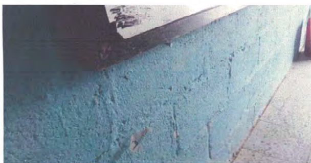
Foto 23: Cernido de paredes que no lo tienen.
