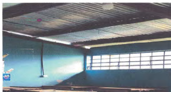
Foto 10: Pintura en muros interiores se encuentra en mal estado.
