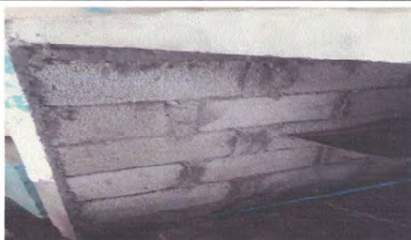
Foto 22: Cernido de las paredes que no tienen.
