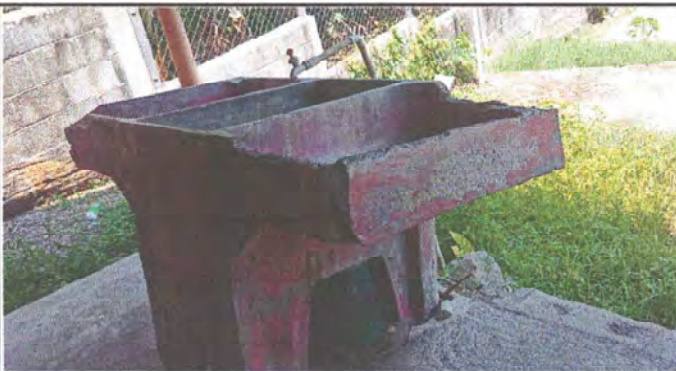
Foto 3: Sustrucción de pila
