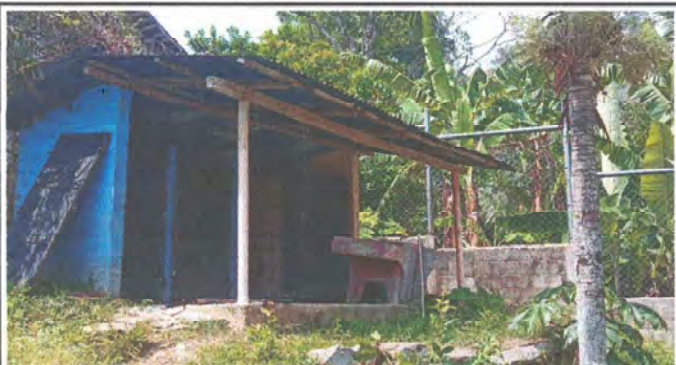
Foto 5: Sustrucción de laminas en techo de baños
