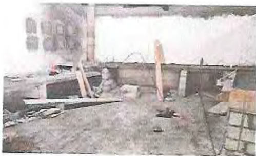
Foto 7: PISO DE LA COCINA DURANTE
