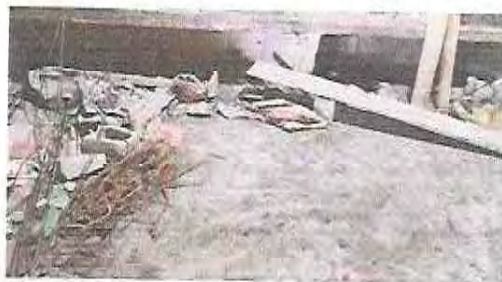
Foto 8: PISO DE LA COCINA DURANTE
