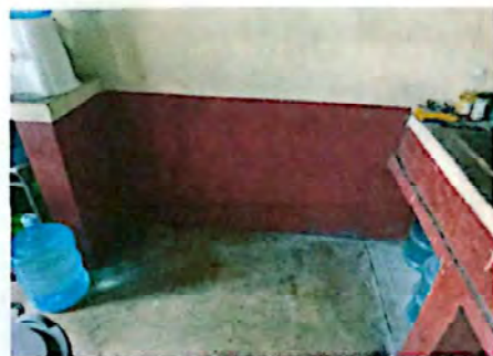
Foto 4: mueble de concreto para preparación de alimentos
