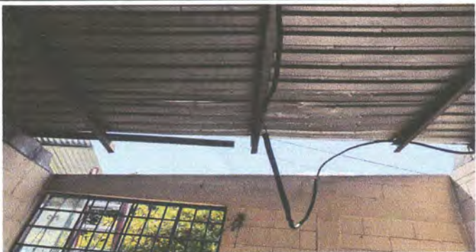
Foto1: Techo de cocina en mal estado
