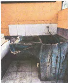
Foto 1: Pila en mal estado, necesita sustitución
