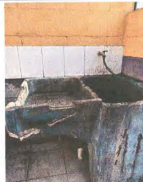
Foto 2: Pila en mal estado, necesita sustitución
