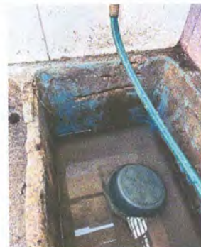
Foto 4: Pila en mal estado, necesita sustitución
