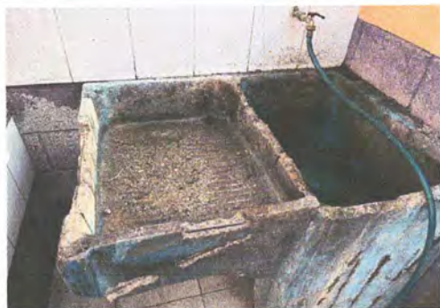
Foto 3: Pila en mal estado, necesita sustitución
