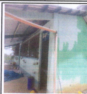
Pintura en las aulas
