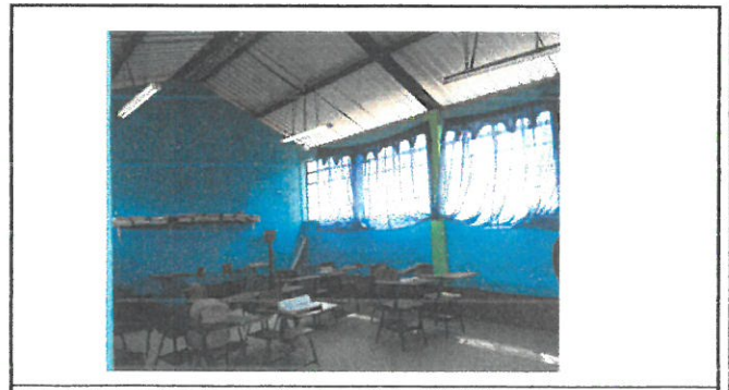
Foto 6: Pintura interior sin ejecutar. Acta 13-2024
