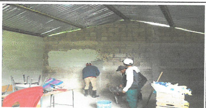
Pared de aula a mejorar con repello.
