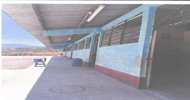
REGION DE TRABAJO 2. REMOZAAMIENTO DE PINTURA, PODEMOS OBSERVAR EL DETERIORO DE LA PINTURA ANTES DE LA EJECUCION DEL QUINTO PROGRAMA.
