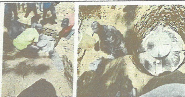
Foto 5: AREA DE BIODIGESTOR
