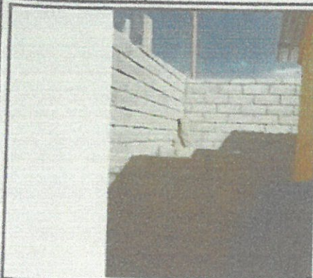
Foto 1: VISTA EXTERNA DEL PROCESO DE LOS BAÑOS LAVABLES.
