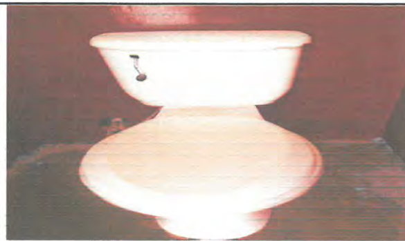
Foto 2: Vista frontal del inodoro en mal estado
