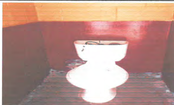
Foto 3: Vista frontal del inodoro en mal estado.
