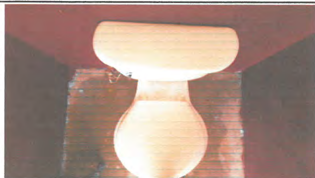
Foto 1: Vista desde arriba del inodoro en mal estado
