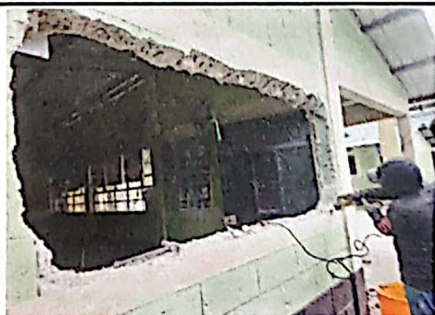
remozamiento de la pared de una de las aulas por calor
