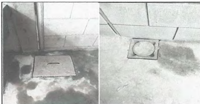
DRENAJE EN LAVANDERIA Y SANITARIO
