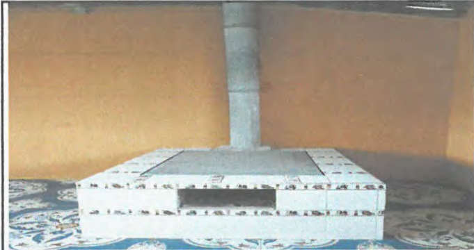
PLANCHA Y CHIMENEA COCINA
