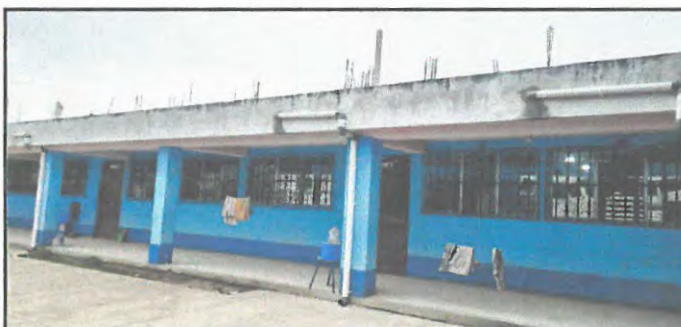
BAJADAS DE AGUA EN TERRAZA
