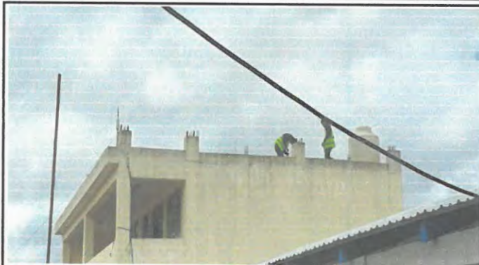
Deposito de agua de politileno de 1, 100 litros instalada sobre terraza.
