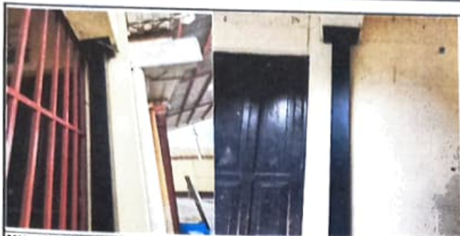
MUROS CON FISURAS
