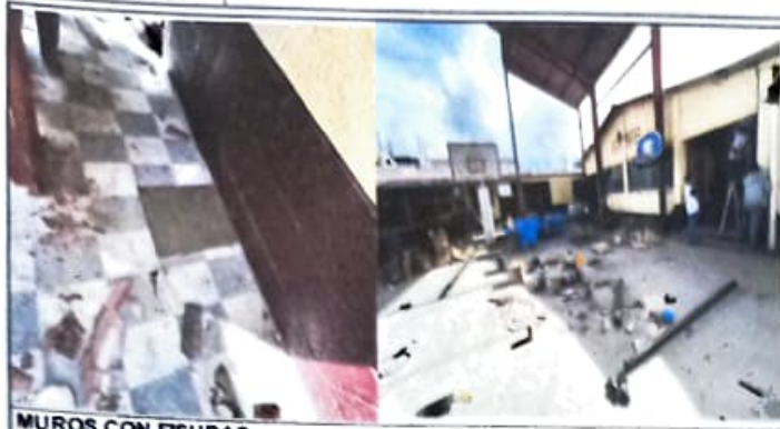
MUROS CON FISURAS
