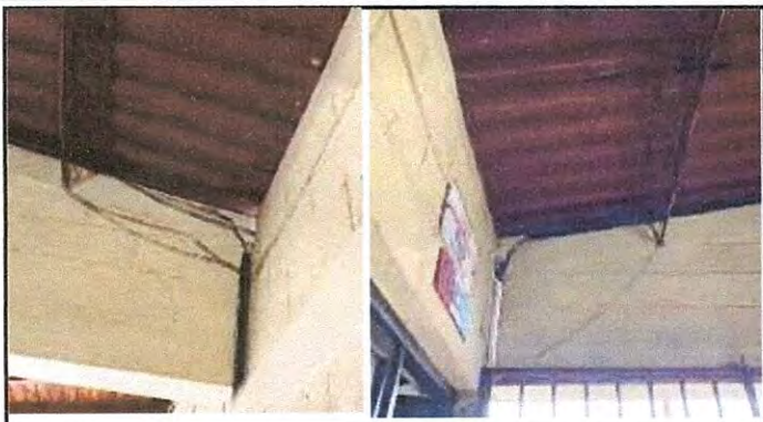
MUROS CON FISURAS
