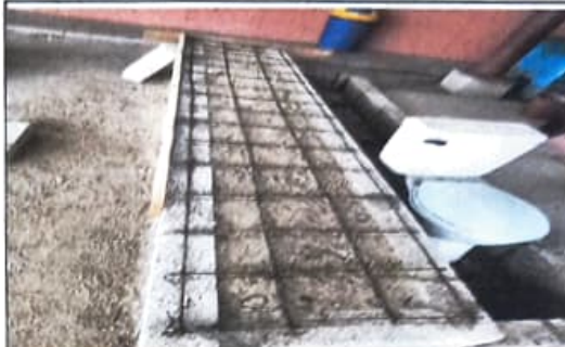
Banqueta en mal estado, interior
