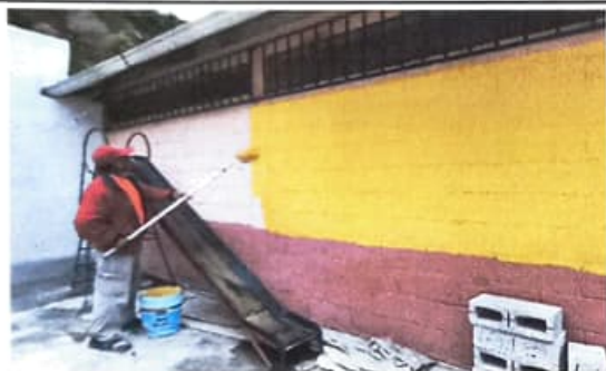
Pintura en mal estado.
