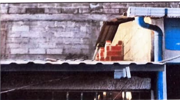
CHIMINEA EXTERIOR DE LA COCINA
