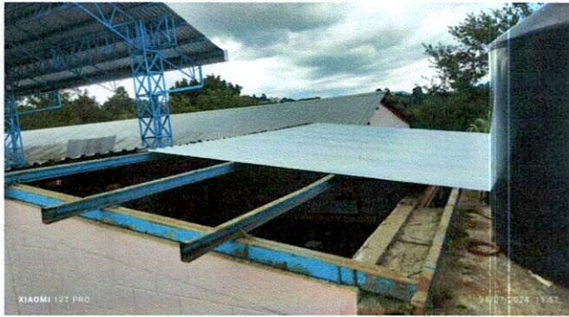
Foto 1: Techo de Aulas en mal estado
