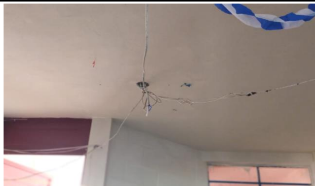
Foto1: Cables colgados en aulas del primer nivel que es un peligro constante para los estudiantes.
