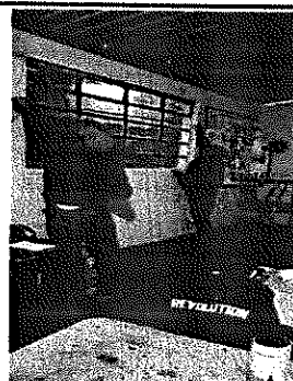
Foto 4: Ventana fijas y en mal estado, módulo 1
