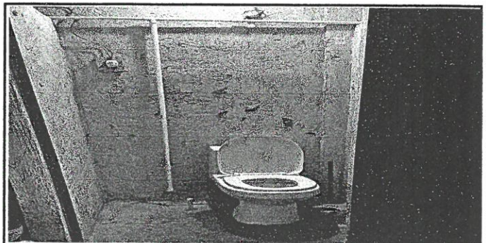
SERVICIOS SANITARIOS INSTALADOS
