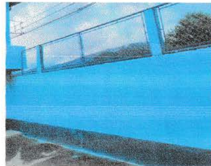
Foto 4: Muro repellido y pintado
