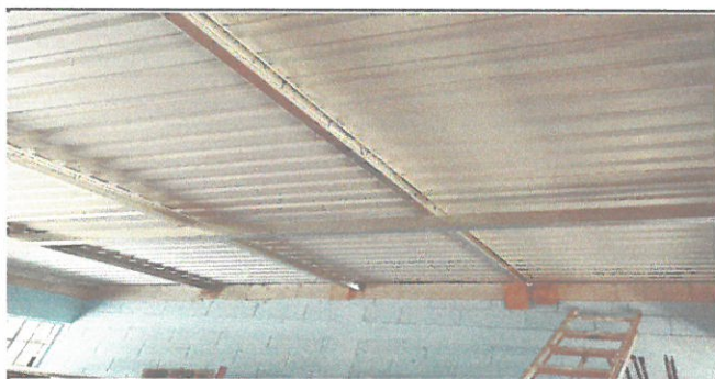
AULAS SIN GOTERAS
