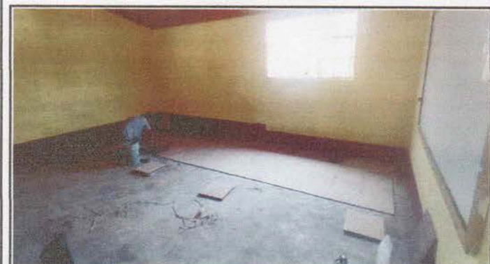
Foto 3: Aula 3: Piso torta de cemento en mal estado. (Se sustituye por piso ceramico)
