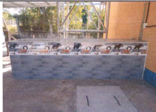
Foto 2: Suministro de gabinete de concreto.
