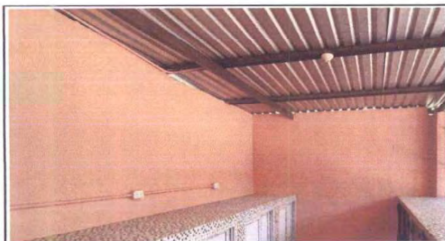
Foto 3: Cernido de muros interiores del área de cocina
