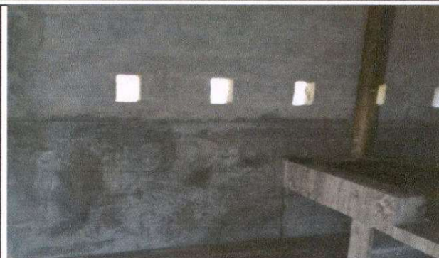
CERNIDO EN MURO INTERIOR
