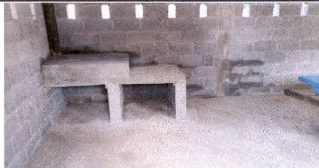
CERNIDO EN MURO INTERIOR
