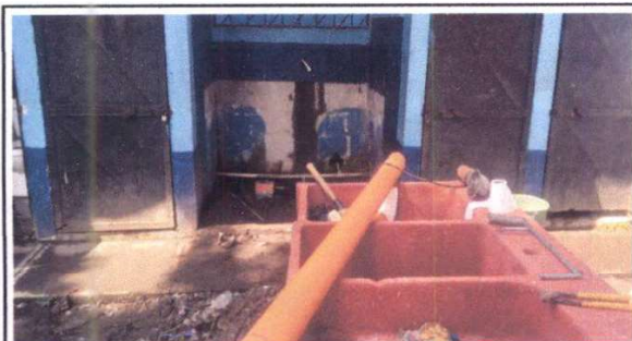
Foto 3: Instalaciones de pilas.
