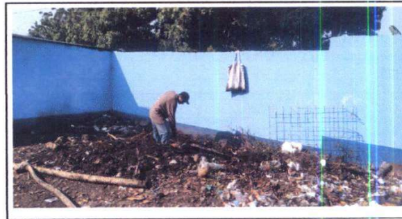
Foto 6: Drenajes de aguas pluviales en mal estado.
