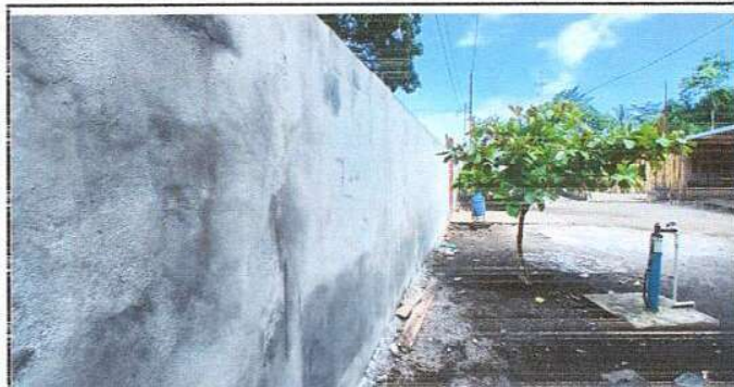
Foto 2: repello en muro perimetral borde interno
